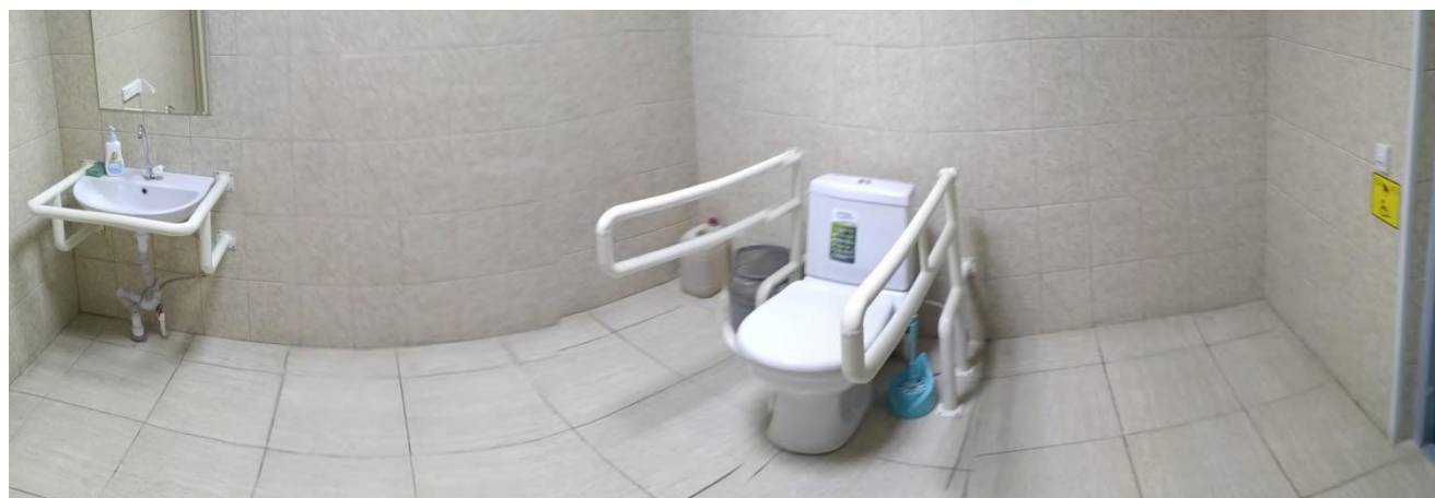
Санузел для лиц с ОВЗ
