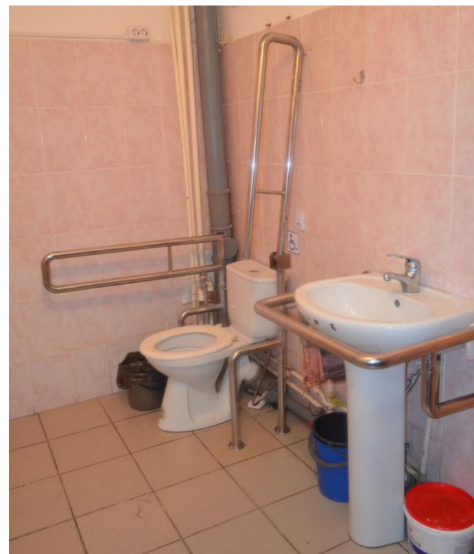
Санузел для лиц с ОВЗ
