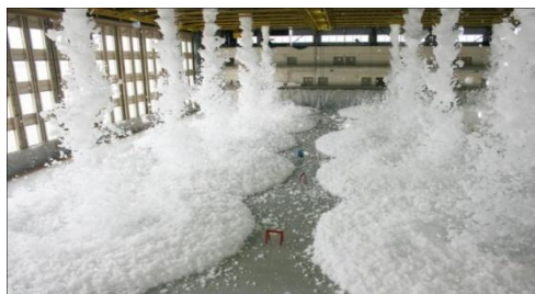
Рисунок 4 - Спринклерная установка пожаротушения
