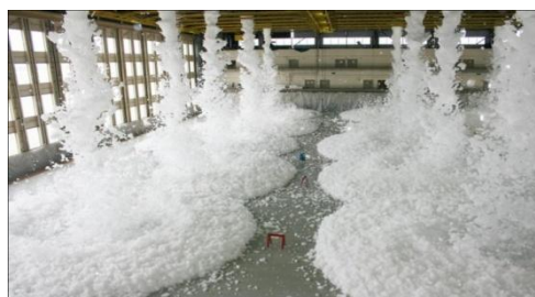
Рисунок 4 - Спринклерная установка пожаротушения
