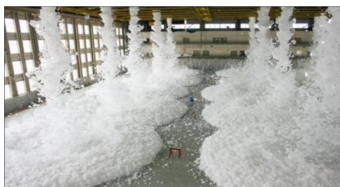
Рисунок 4 - Спринклерная установка пожаротушения
